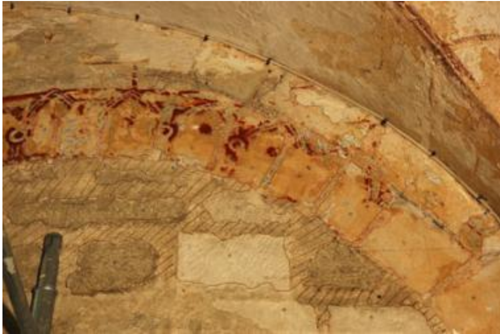
Fig. 1. Déambulatoire nord, mur sud, 3 e travée : relevé archéologique des couches picturales (relevé C. Castillo).
